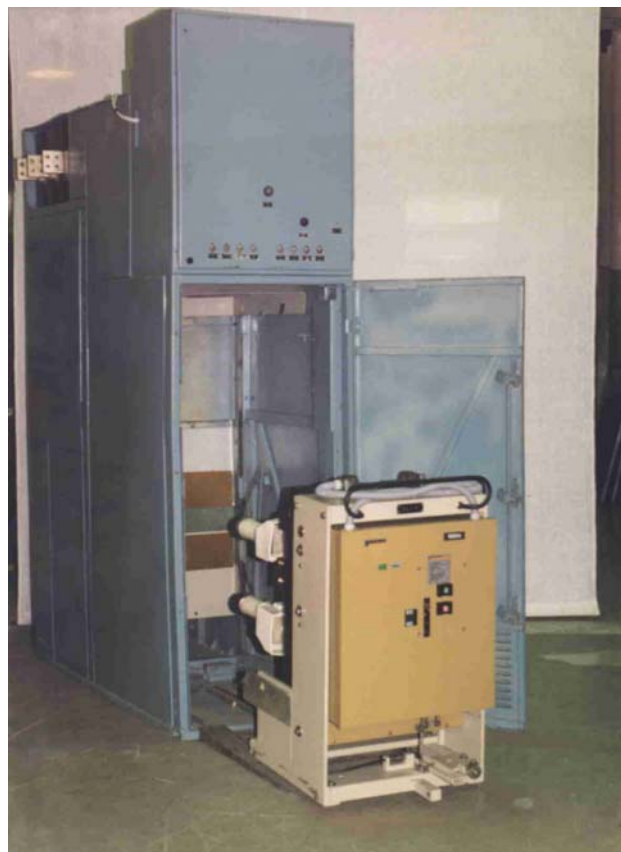
Вид в составе КРУ
