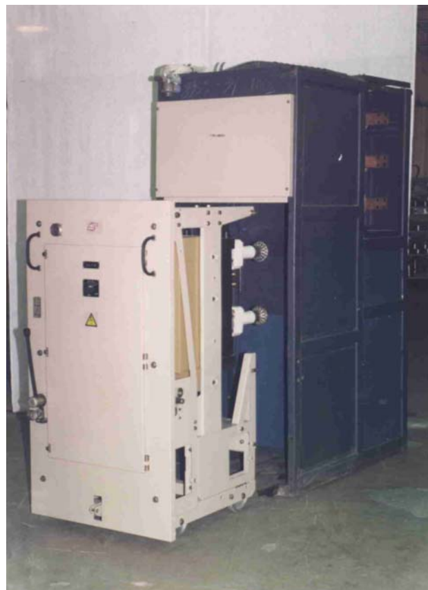
Вид в составе КРУ
