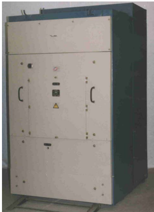
Вид в составе КРУ
