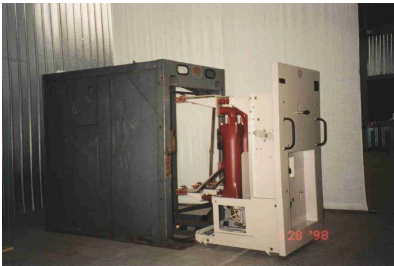
Вид в составе КРУ
