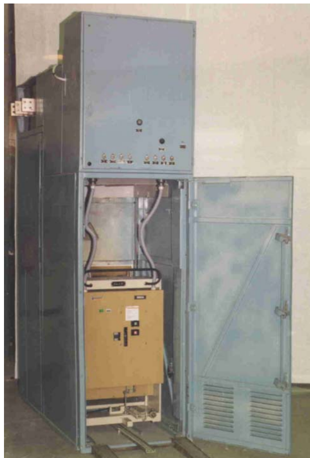
Вид в составе КРУ
